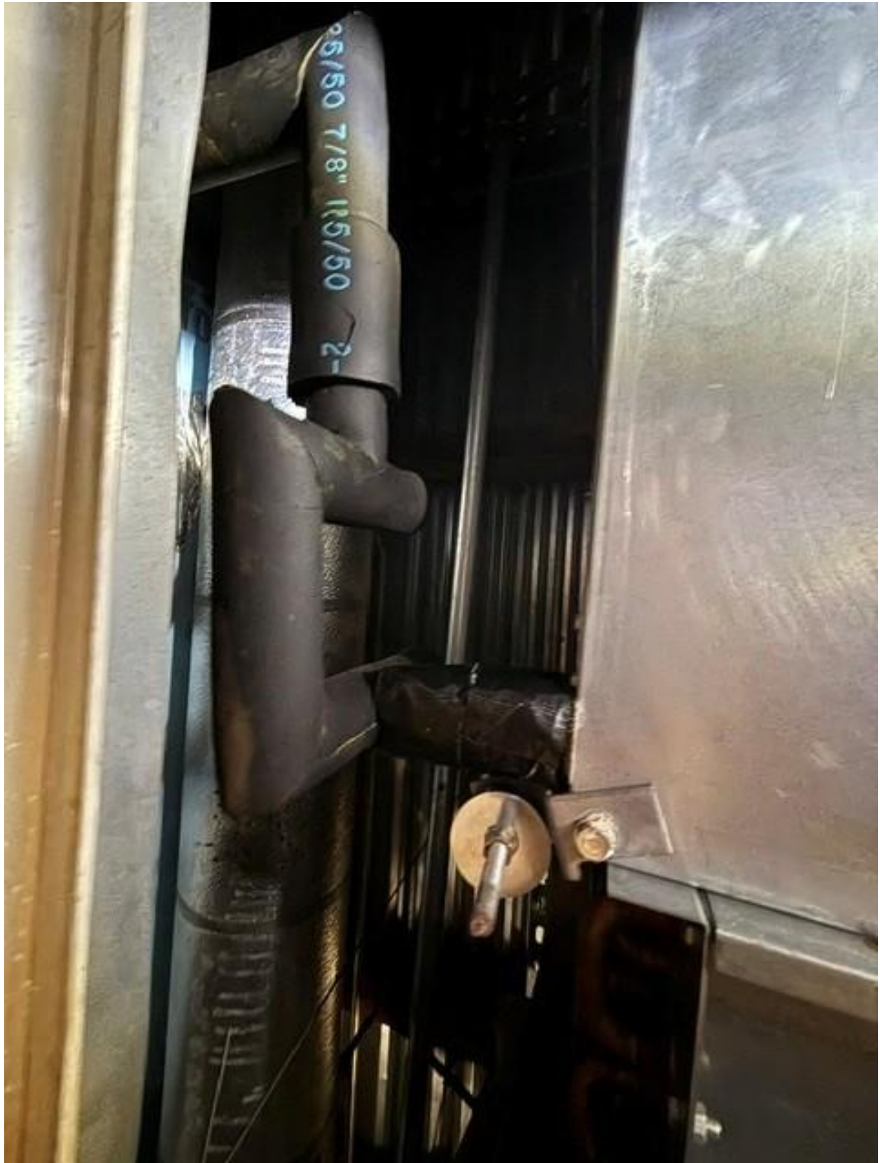
DOAS – Condensate Drain
